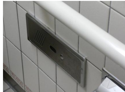
トイレの消音節水器機
